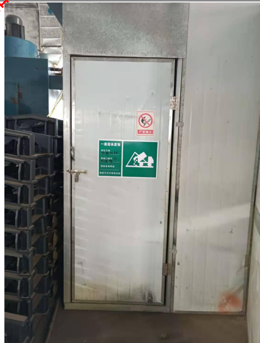
一般固废暂存标识牌
