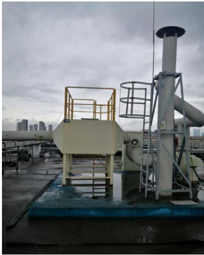
2#有机废气排口（原焊接废气排放口） （过滤棉+活性炭吸附装置+25m 排气筒）
