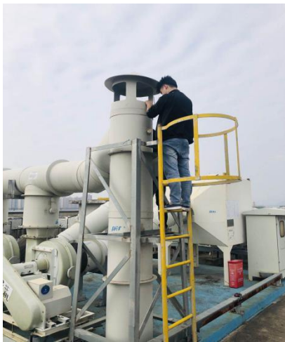
4#有机废气排口（原焊接废气排放口） （过滤棉+活性炭吸附装置+25m 排气筒）
