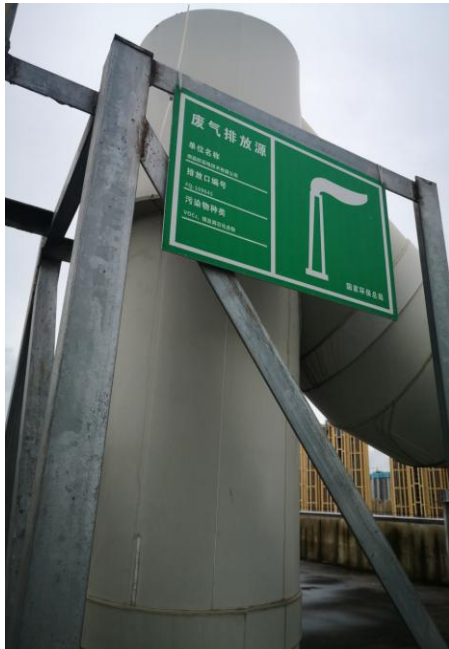
废气排放口标识牌
