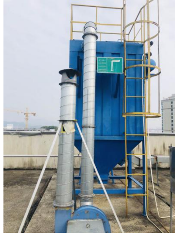
6#破碎废气排口 （旋风除尘器+布袋除尘器+25m 高排气筒）
