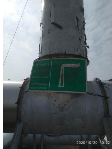
3#有机废气排口（原焊接废气排放口） （过滤棉+活性炭吸附装置+25m 排气筒）
