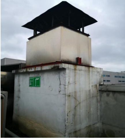
7#锅炉废气排放口（20m 高排气筒）
