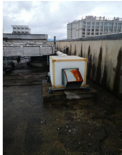
2#厂房通风排气口（25m 高排气筒）
