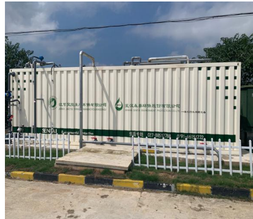
图 3-3 污水处理设施
